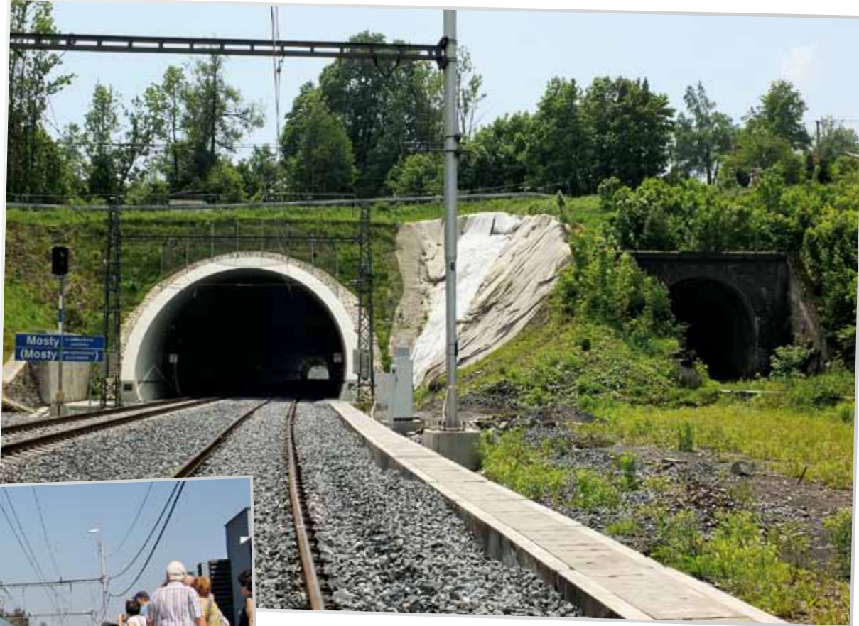
KONEČNĚ HOTOVO. Nový tunel u Mostů u Jablunkova vznikal déle, než se plánovalo. Na vině bylo prosakování vody a propad zeminy. FOTO AUTOR (2x)
