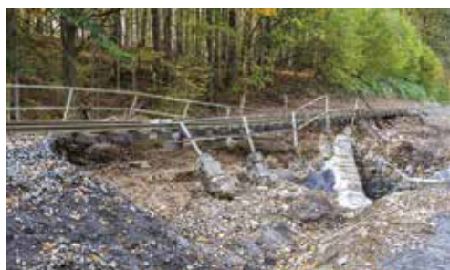
Zničený propustek trati na Zlaté Hory
